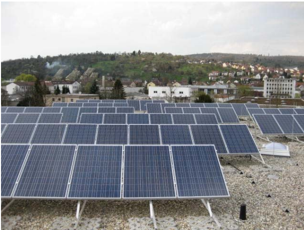
Abbildung: Photovoltaikanlage Berufschulzentrum Zell 2008
