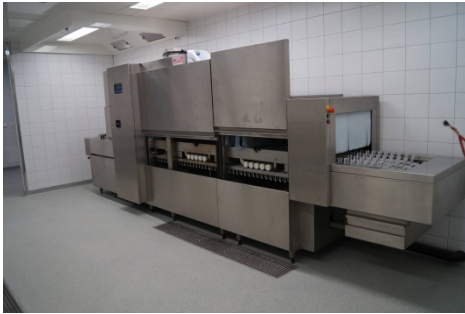
BA 6: Spülküche: Wiedereinsatz der überholten Bandspülmaschine
