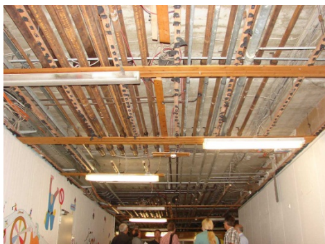
3. Bauabschnitt Flur Hanggeschoss: Installationsgedränge in der Abhangdecke
