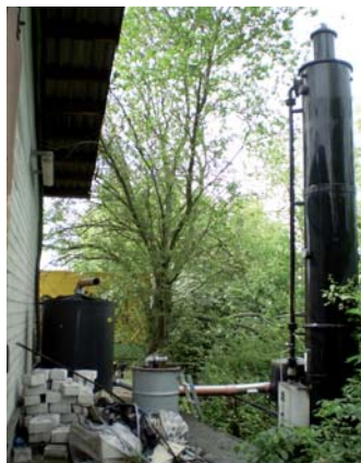
Strippturm mit Aktivkohleinheit zur Beseitigung von leichtflüchtigen Schadstoffen aus dem Grundwasser.
